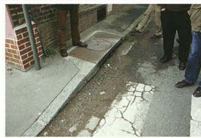
un mauvais écoulement de l'eau bouche l'égout
