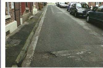
les nids de poule sur la chaussée sont répertoriés
